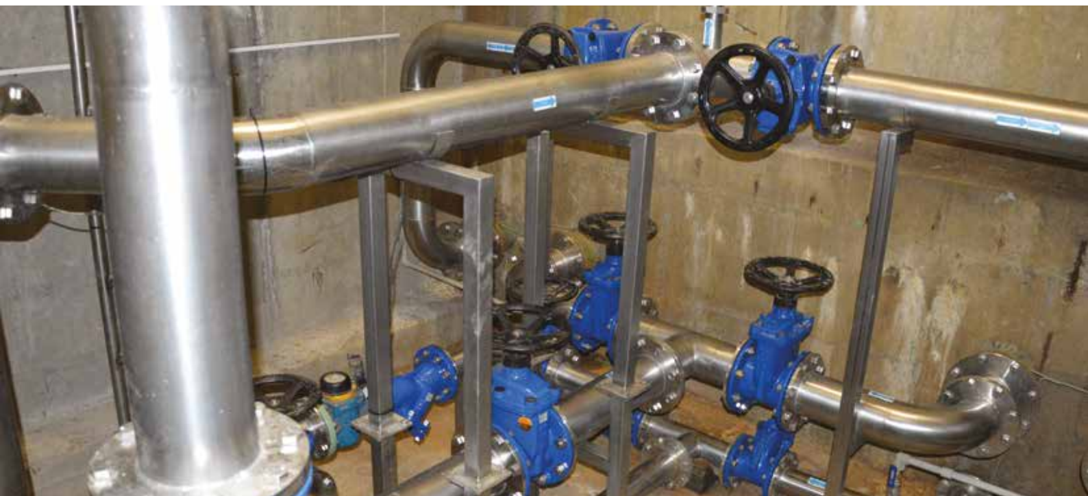
Nově vystrojená armaturní komora VDJ Vsetín Sychrov HTP
