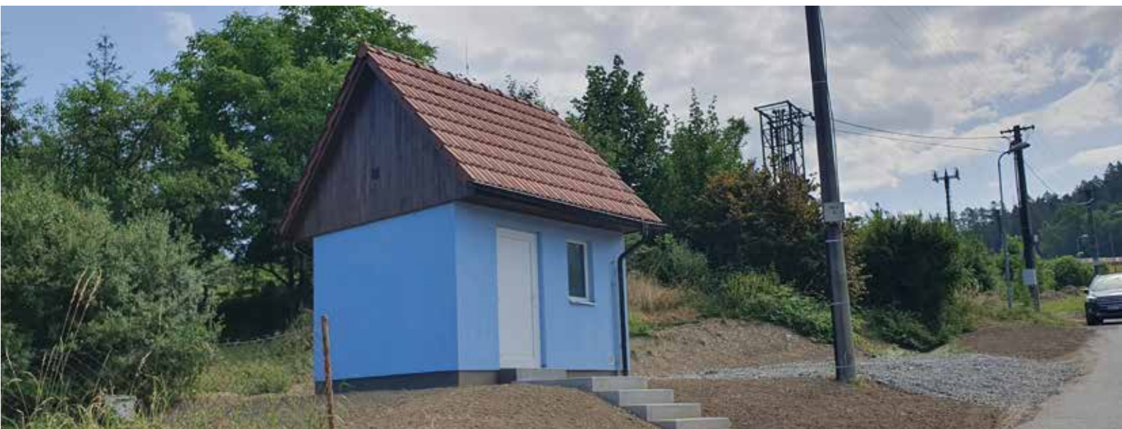
Nová automatická tlaková stanice Valašské Meziříčí - Hrachovec
