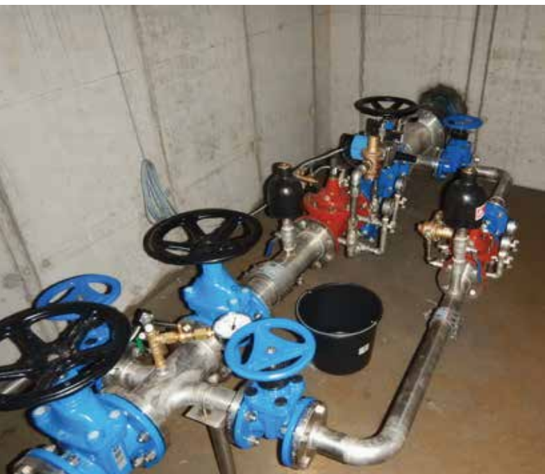
Regulační šachta Rožnov p. R., Záhumení - turbína pro výrobu el. energie
